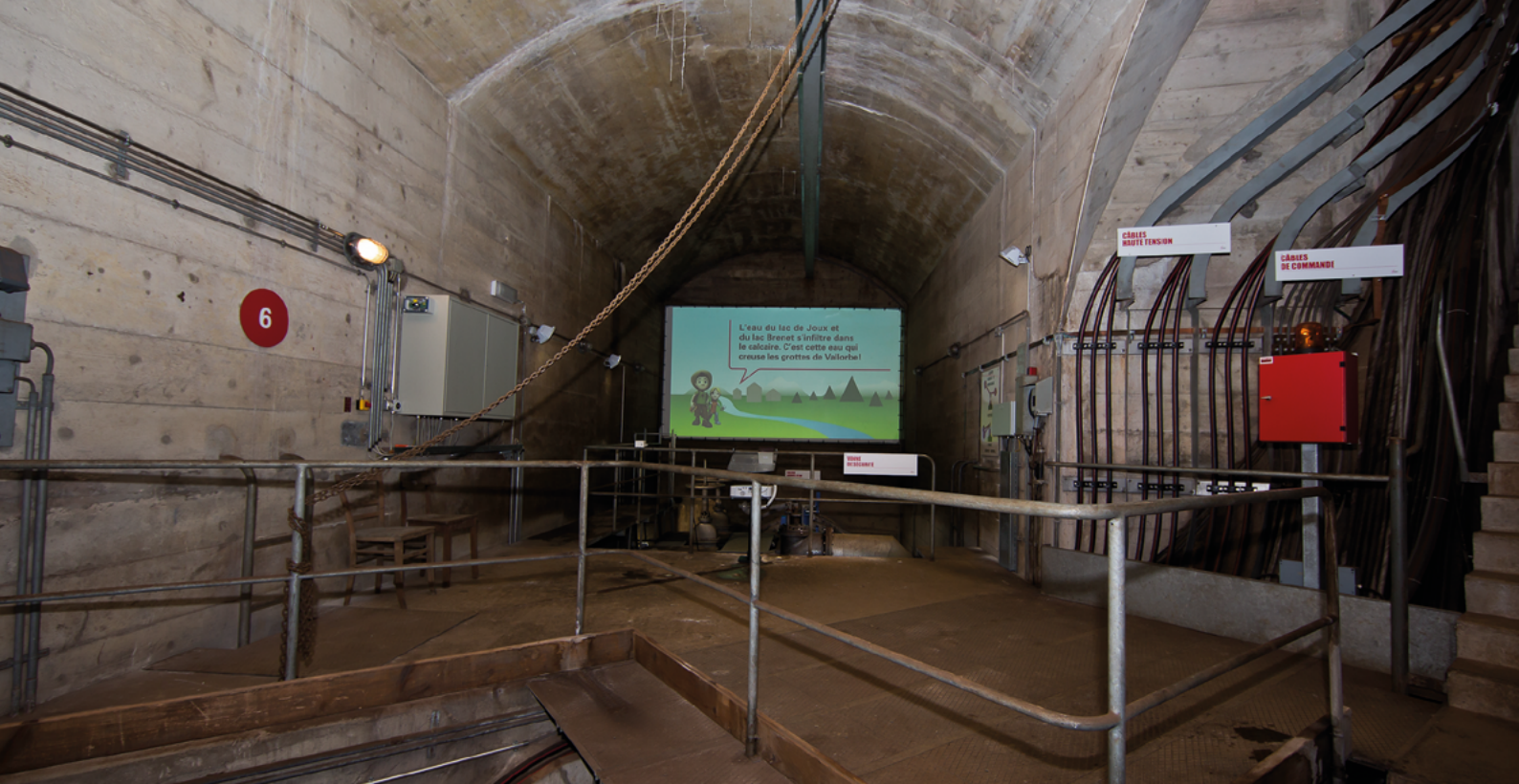
La conduite forcée, au milieu du tunnel du funiculaire 6
