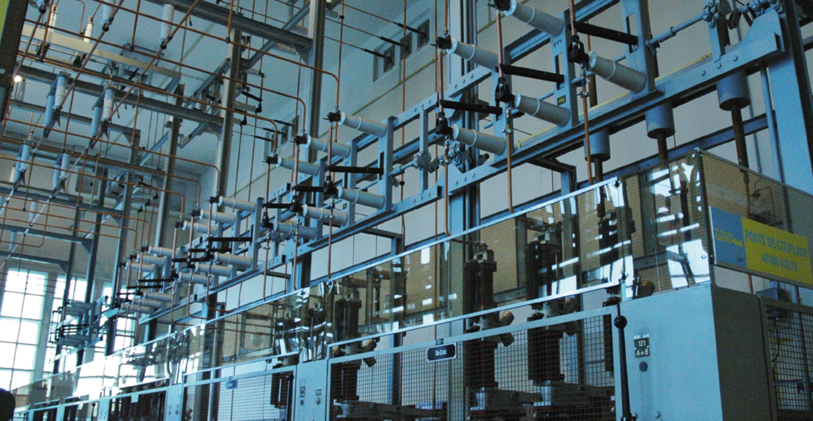
Le poste de couplage de la Centrale des Clées 12
