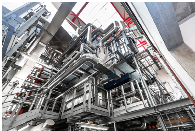
La salle des machines
