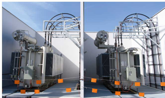
Deux transformateurs du poste électrique de Moudon
