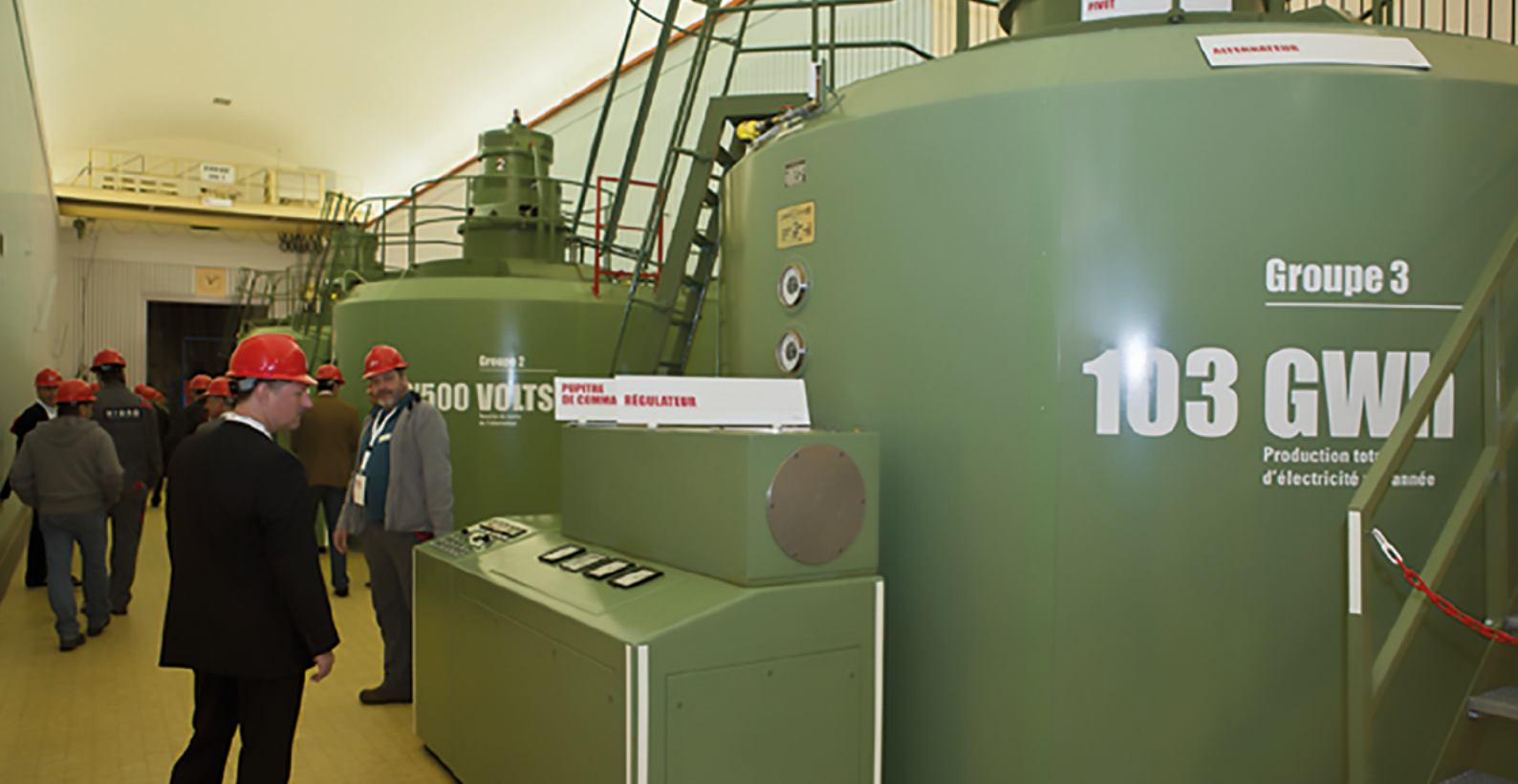
La salle des machines de la Centrale des Clées 9
