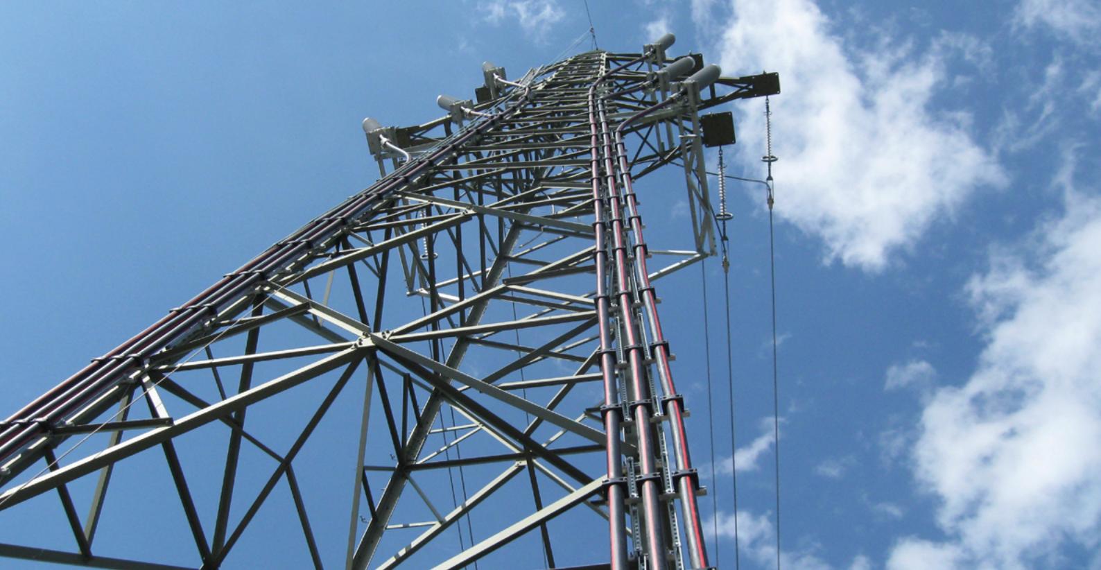
Pylône électrique haute tension (HT) >40'000 volts
