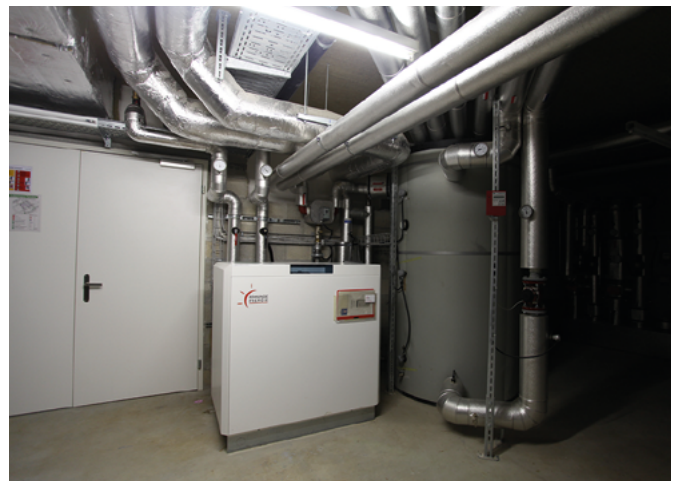
Pompe à chaleur
