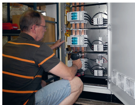
Installation d'une batterie de compensation.
